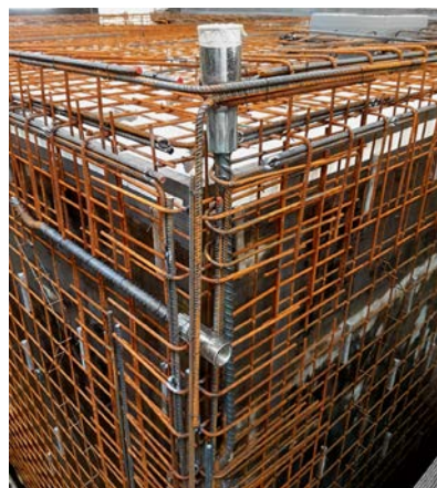
Stahlarmerung einer Station als Bestandteil eines Erdungs- und Blitzschutzkonzeptes
