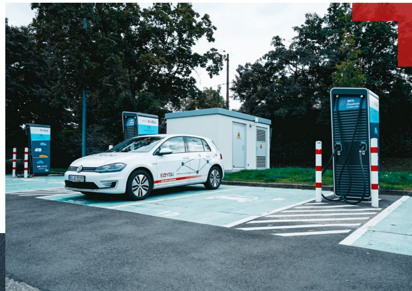
Station im öffentlichen Bereich zur Versorgung einer Ladesäule
