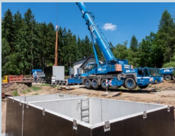
5. První akumulční a střední armaturní komora
